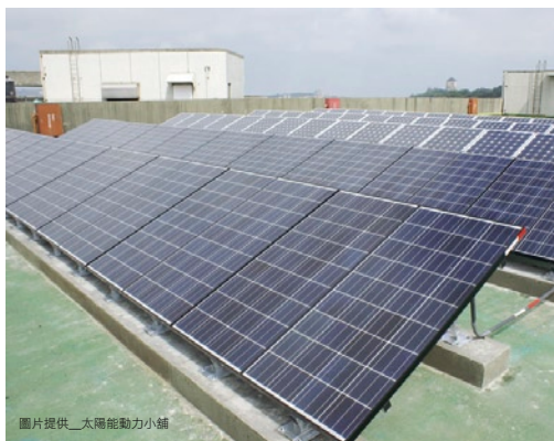
太陽能板可發電又可為屋頂遮陽。
