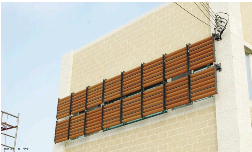
因應陽光角度不同，得裝設可調整角度的遮陽板。
